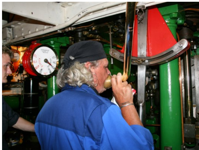
Maszynownia statku w 2022 roku
