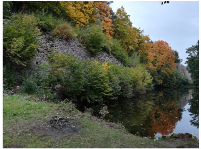
Uszkodzony mur oporowy
