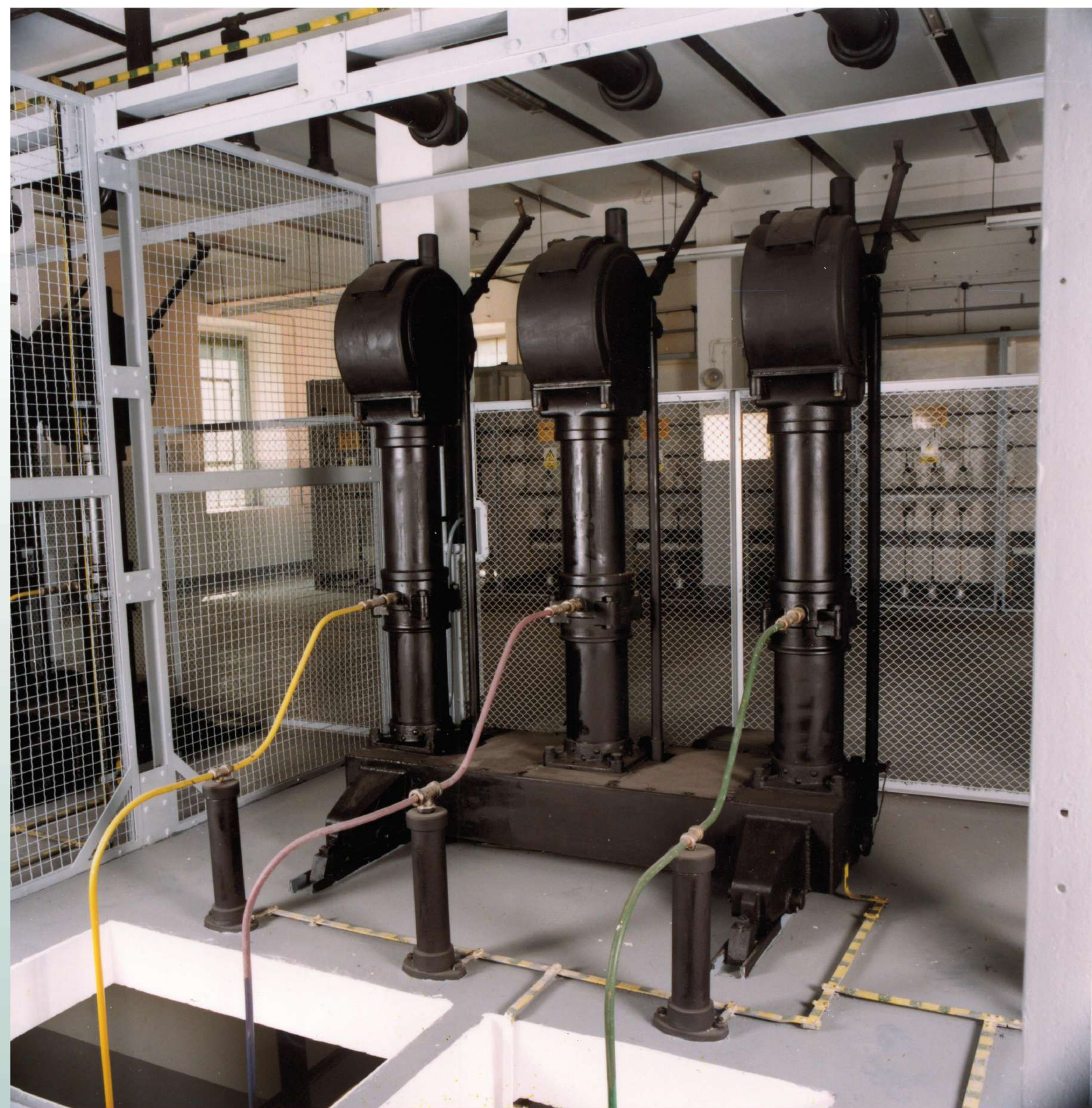
Odłączniki mechaniczno - hydrauliczne SSW w rozdzielni 1913 r.
