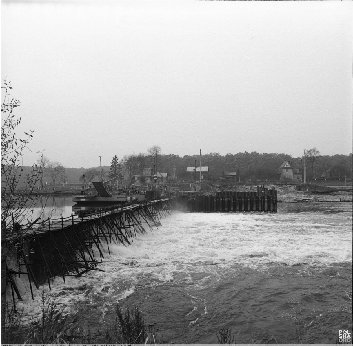
Jaz kozłowo-iglicowy od dolnej wody w czasie budowy fundamentu pod lewe przęsło jazu sektorowego.
