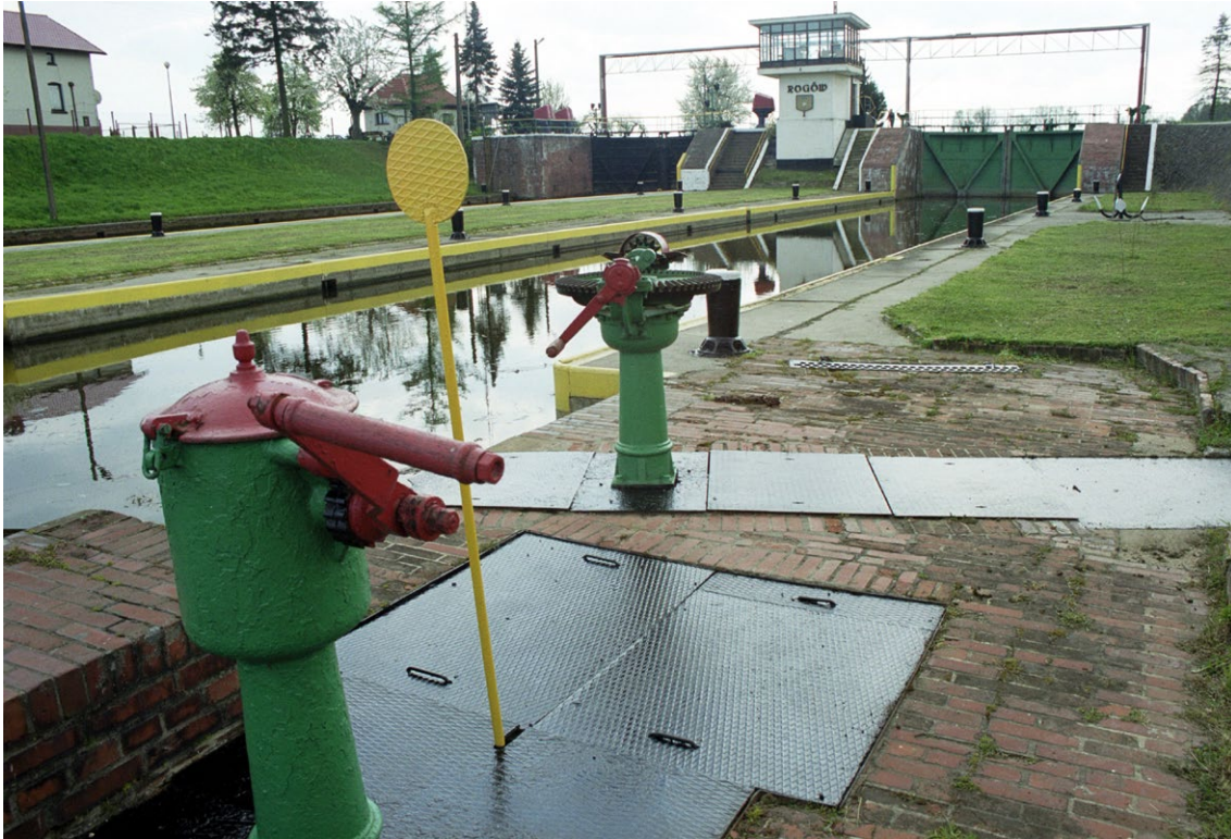
Śluzy komorowe. Widok na wrota górne i sterówkę. Na pierwszym planie mechanizmy napędowe wrót dolnych śluzy małej.
