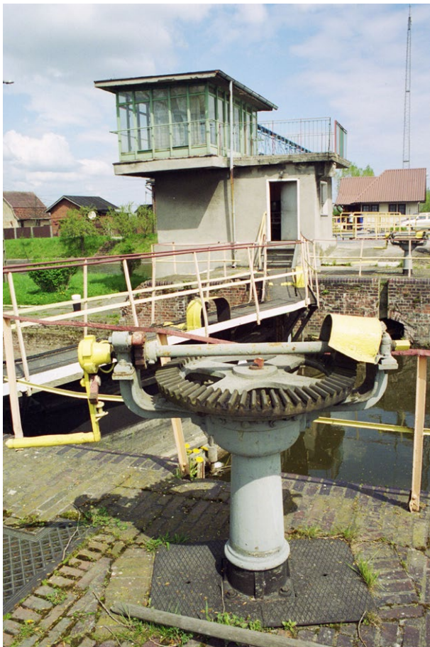
Oryginalne napędy wrót górnych śluzy małej i sterownia śluz.
