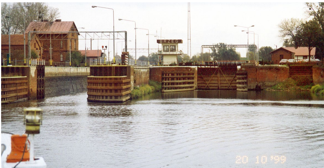
Awanporty i głowy dolne śluz: dużej (pociągowej), małej i zasypanej. Także zabudowy przystopniowej. Widok ze statku inspekcyjnego RZGW we Wrocławiu „Kościuszko”.
