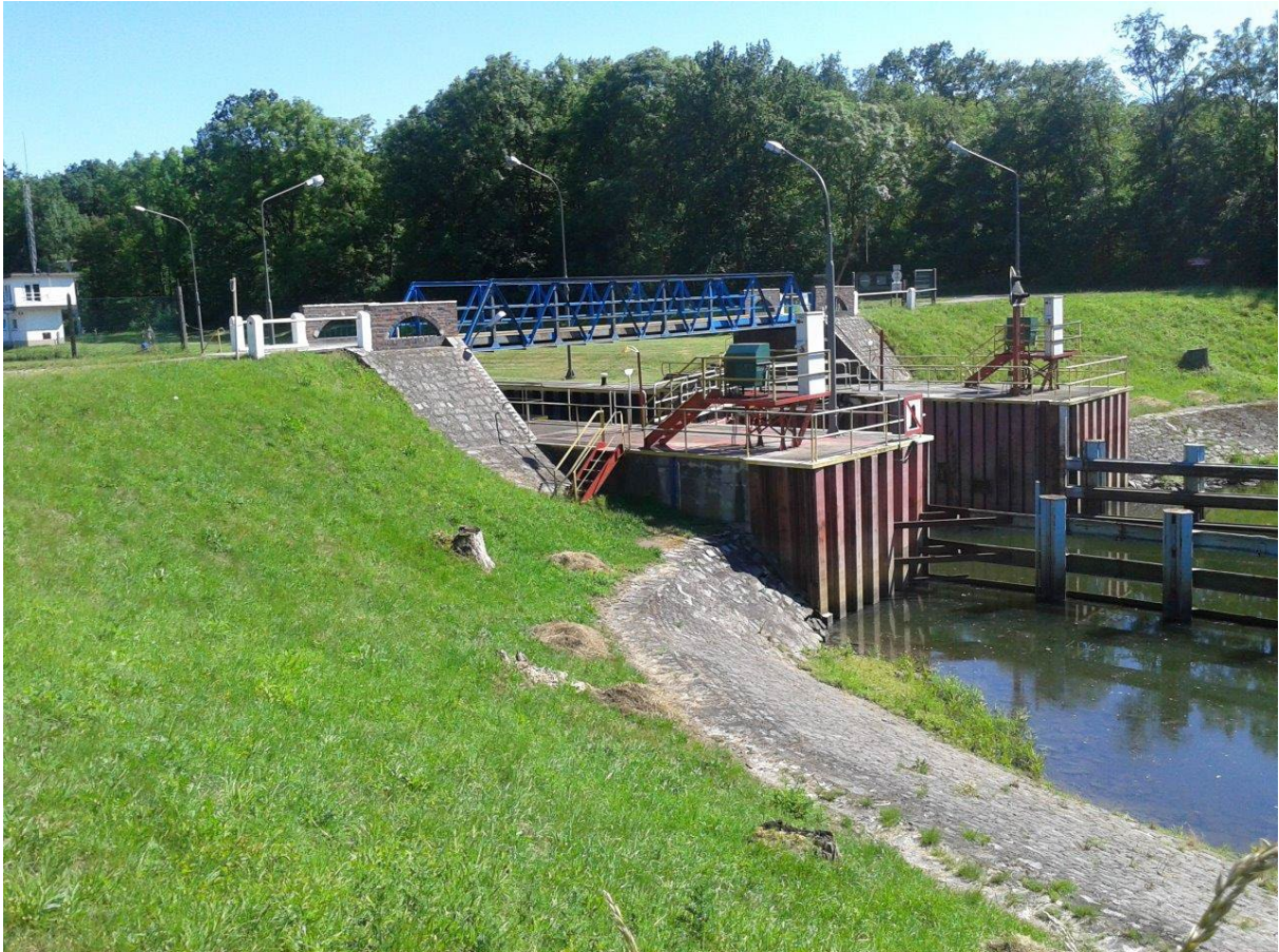
Śluza pociągowa Ratowice – widok na wrota i oryginalny most nad głową dolną od wody dolnej (po remoncie w połowie lat 90-tych XX w).
