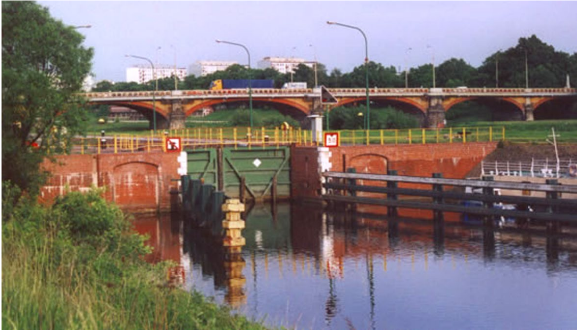
Awanport i głowa dolna śluzy Różanka przed remontem w ramach modernizacji Wrocławskiego Węzła Wodnego. W głębi sylwetka mostu Osobowickiego.
