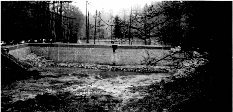
Zrewitalizowane zbiorniki wody pitnej (fot. podczas odbioru technicznego,) położone powyżej zlikwidowanego zakładu włókienniczego w Gluszyca, w Górach Sowich, w Nadleśnictwie Wałbrzych
