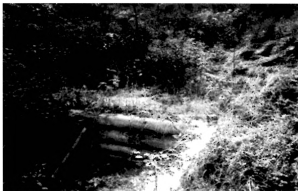
Jedno z mniejszych urządzeń wspomagających retencję, spowalniające spływy wód rynnami erozyjnymi i rewitalizujące środowisko leśne – efekt po zalądowaniu i sukcesji roślinności
