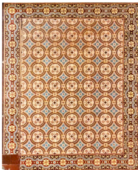
Płytki typowe podestów parteru oraz pięter główniej klatki schodowej, fot. K. Komar-Michalczyk, 2021
