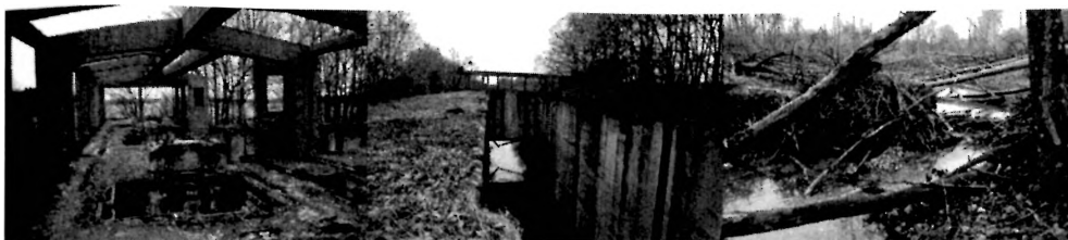
Widok pozostałości obramowania sterówki, komory śluzowej oraz podejścia od strony głowy górnej śluzy Gross Allendorf/Kostromino (autor: C. Warczyński)
